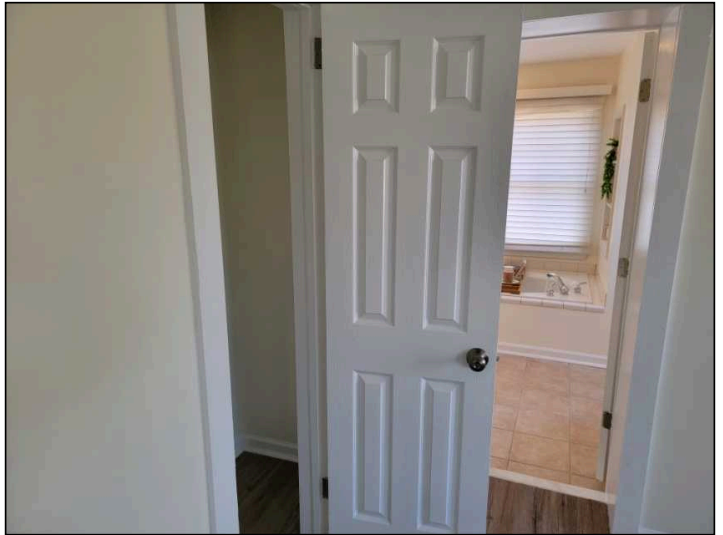
Door Rubs & Loose Hinge (Master Closet)
